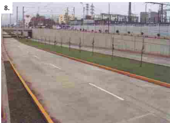
8. Para la realización del proyecto se tomaron en cuenta las instalaciones subterráneas así como las torres de alta tensión que pertenecen a Luz del Sur a fin de no interrumpir el suministro de energía a cinco distritos de la capital.
